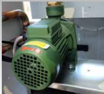
Pompa di circolazione - Pompa recirculare
